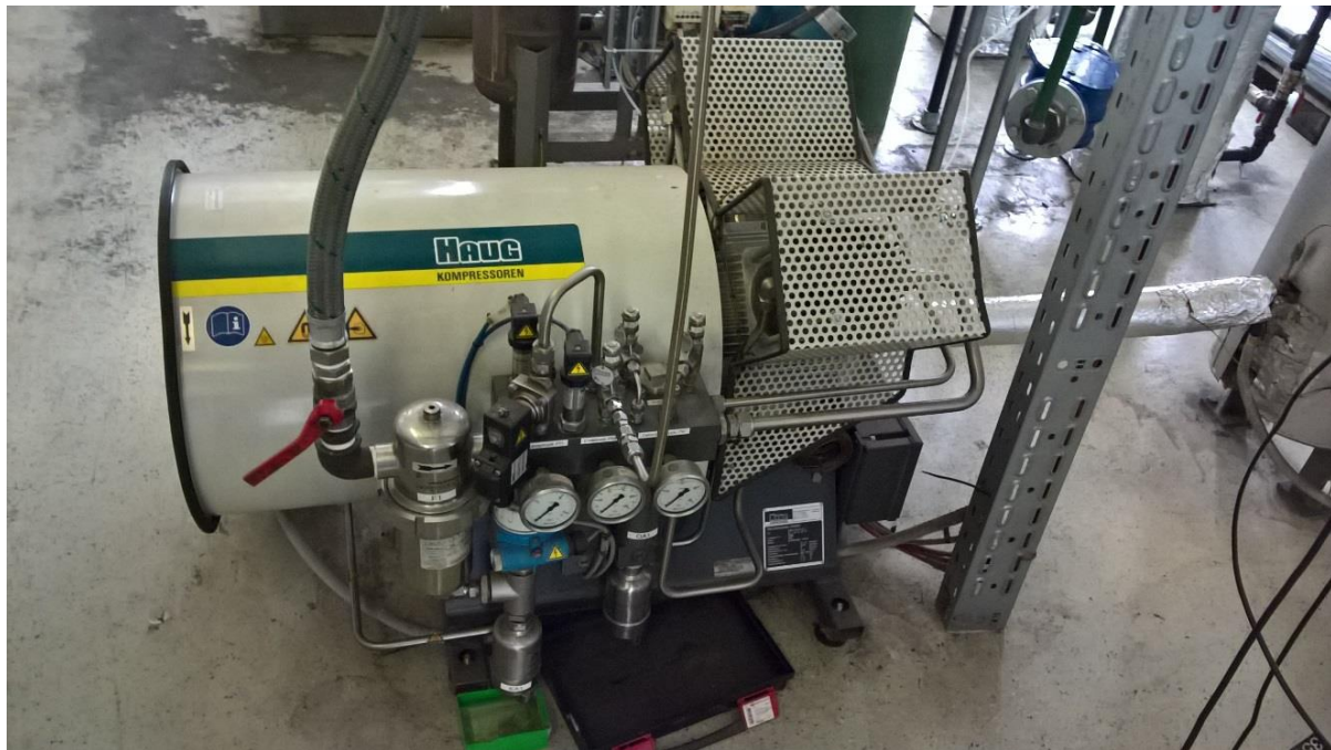
Abbildung 5.3: Kompressor der Anlage
